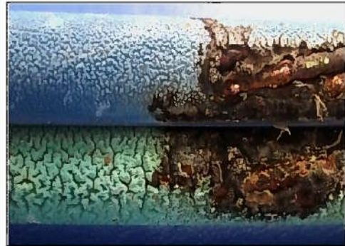
【写真3】トラッキングにより焼損した例 (製造年不明)
